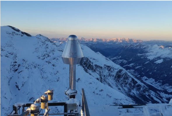
Abb.1: Zentrale Ansaugung für Spurengasmessungen Fig.1: Central sampling manifold for trace gas monitoring Quelle/Source: Umweltbundesamt
