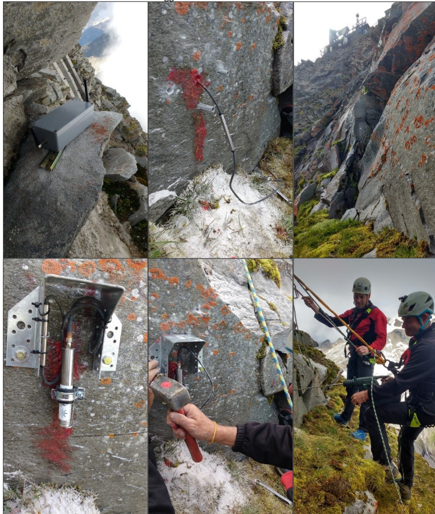
Fotos: Installation des Nordwandlogger 01 im Jahr 2016.
