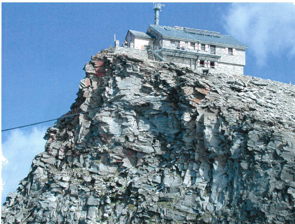
Foto 7: Gipfelaufbau – Nordwestpfeiler-Nordwestwand: Ansicht des oberen Pfeilers (mit intensiver Aufblockung) sowie der oberen Nordwestwand mit markantem Großausbruch (in Bildmitte) nach Kluftchar K 3, Dachbildung durch Schieferung
