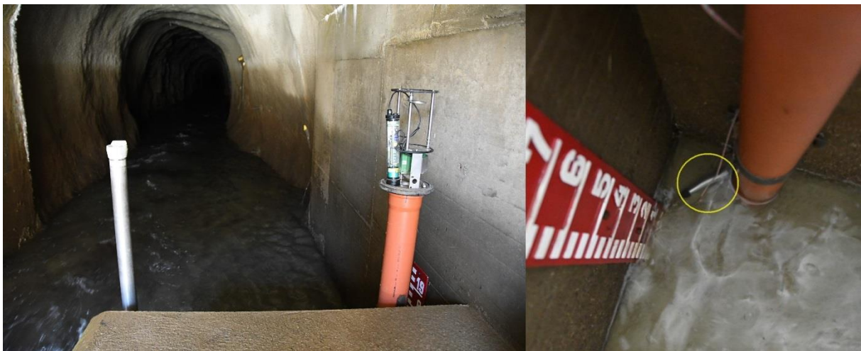
Abbildung: Abflusspegel Kleinfleißbach (links) und der installierte Drucksensor (rechts) am 13.06.2017 im Überleitungsstollen (Fotos: G.Weys).
