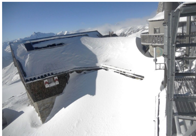
Über Nacht—Eingang Zittelhaus eingeschneit—4m hohe Schneeverwehung. Foto von H. Scheer Overnight—Entry of Zittelhaus is snow-covered—snow drift of 4m height. Photo by H. Scheer.
