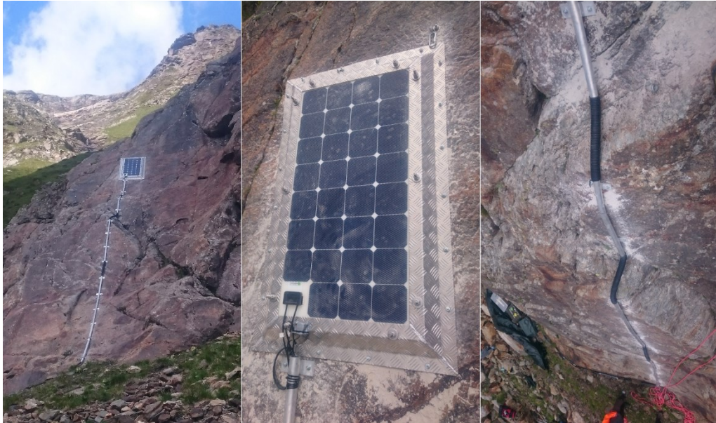
Abbildung 33: Der neue Sonnenkollektor der PIL Station. Aufgrund der lokalen Herausforderungen fiel die Ausführung massiv aus.
